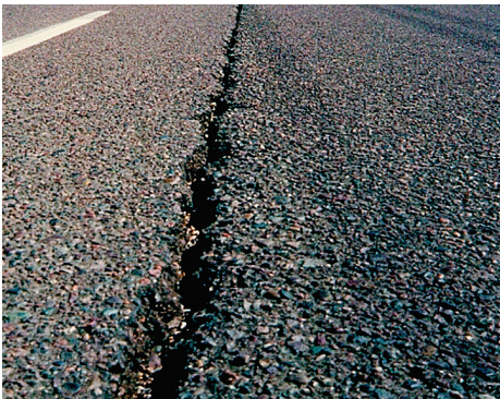
Carretera Sin Tratar
